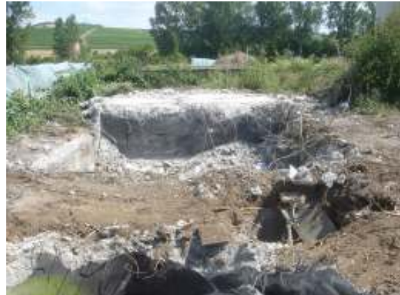
Abbildung 9: Betonfundamente behindernder Kläranlagenbauten
