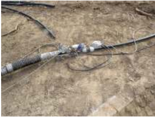
Abbildung 6: Grundwasser Steuer- und Förderleitungen
